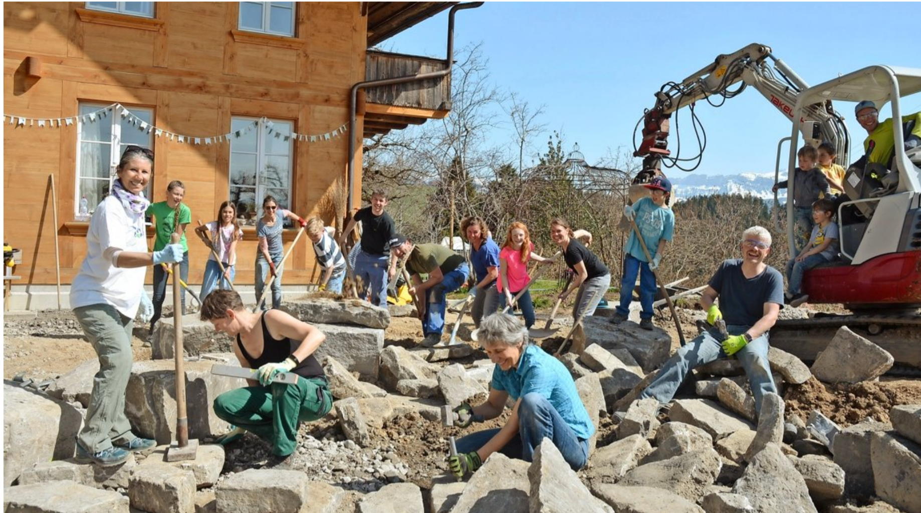
Theaterleute haben während rund dreier Wochen mit Unterstützung von Freiwilligen von Pro Natura und einem Fachmann eine Natursteinmauer als Teil des Bühnenbildes für das kommende Freilichttheater in Heimenschwand gebaut.
